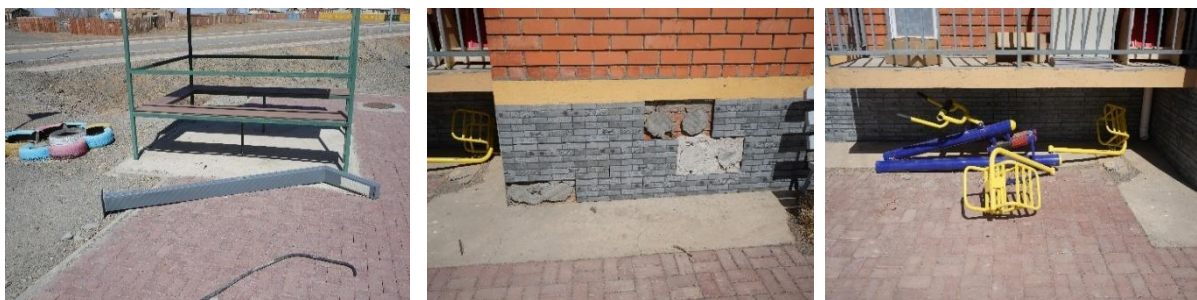
Зураг №02 Ханхонгор сумын 10 айлын орон сууцны барилгын гадна тохижилт хийгдээгүй байдал
