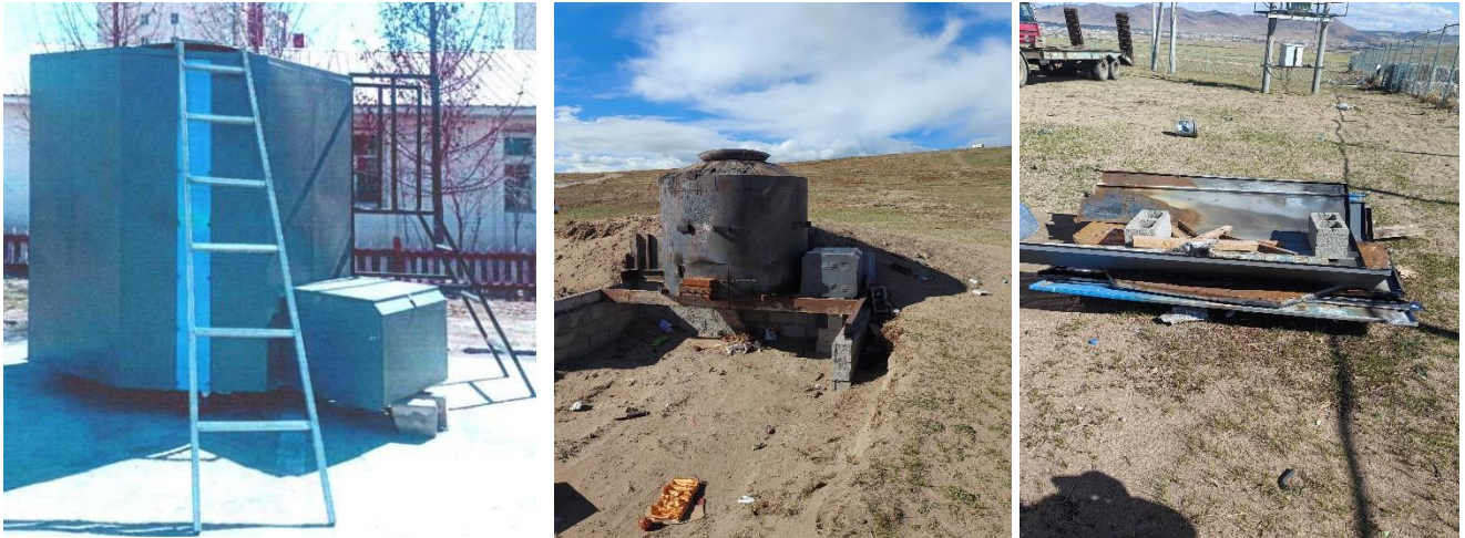
Зураг 1. Аюултай хог хаягдал шатаах зуухны гадна хамгаалалт хуурч унасан байдал
